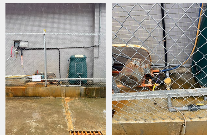
回收水使用：洗車台下方沉澱池抽取水再利用於洗車
